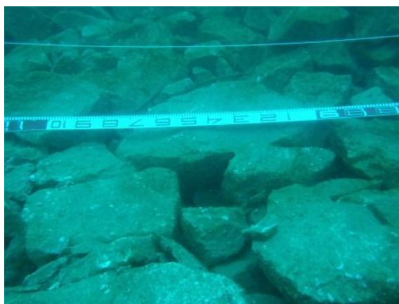
(c) 防波堤（東第一）（高知港）
