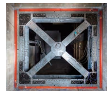
面状発熱体の設置状況
