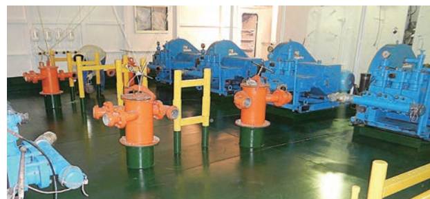
改装後のデコム7号機械室(右奥がプランジャーポンプ)
