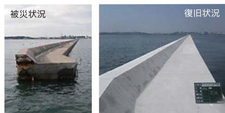
被災状況 復旧状況 塩釜漁港の東防波堤において、海中に倒壊した区間(133m)の復旧と沈下した区間の(1,190m)嵩上げの施工を行い、2014年10月に完了しました。
