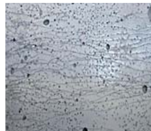
タフリード表面の複数の微細ひび割れ発生状況(幅20μm程度以下)
