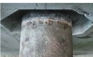
鋼管杭と上部工の接合部の腐食状況
