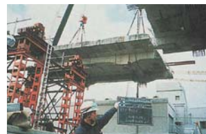
阪神・淡路大震災復旧工事 山陽新幹線阪水工区 被災状況（上） 山陽新幹線阪水工区 復旧工事（下）
