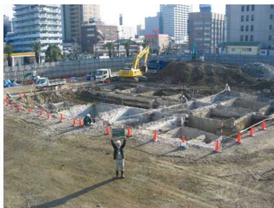
写真2 残存地中構造物
